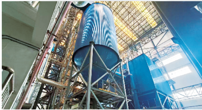
发电厂内部设施。
